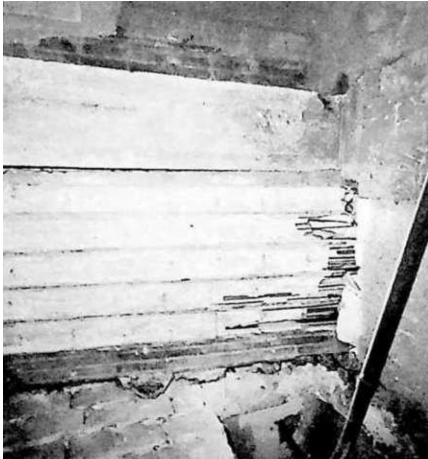
Sede di via T. Stigliani. Particolari del degrado strutturale: pilastro e solaio.
